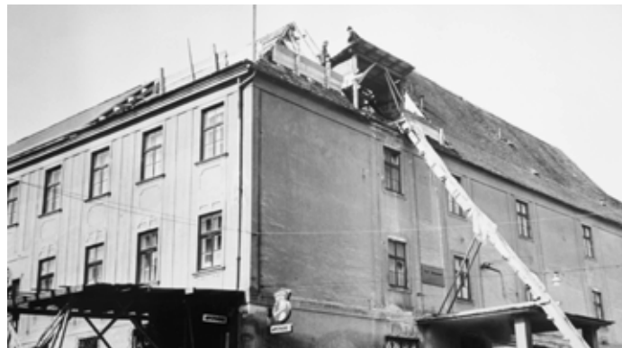
In den 1960er Jahren wurden umfassende Baumaßnahmen durchgeführt (neuer Dachstuhl beim Altbau 1968-1969)
